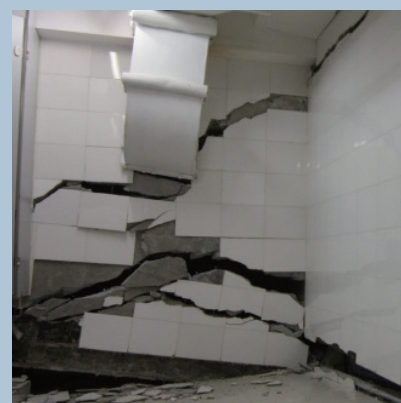
某钢结构建筑（民用建筑） 夹层塌陷事故鉴定
